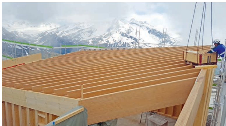
Die Zimmerleute montierten für die Dächer der beiden Restaurants Sparren aus BauBuche.
